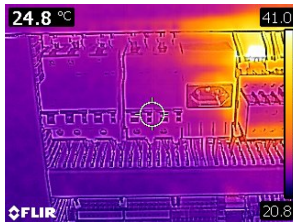
Figura 5 – Contator energizado interferindo na temperatura dos componentes ao redor.
